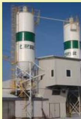
Węzeł betoniarski w Śniadowie
